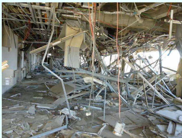
写真③天井は抜け、ケーブルや配線が垂れ下がり床はガラス片やボード等の破片が散乱していて足の踏み場もない。
